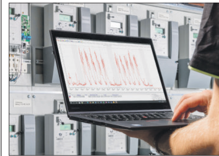
Dank moderner Zähler ist der Verbrauch zeitnah einsehbar. zvg.
